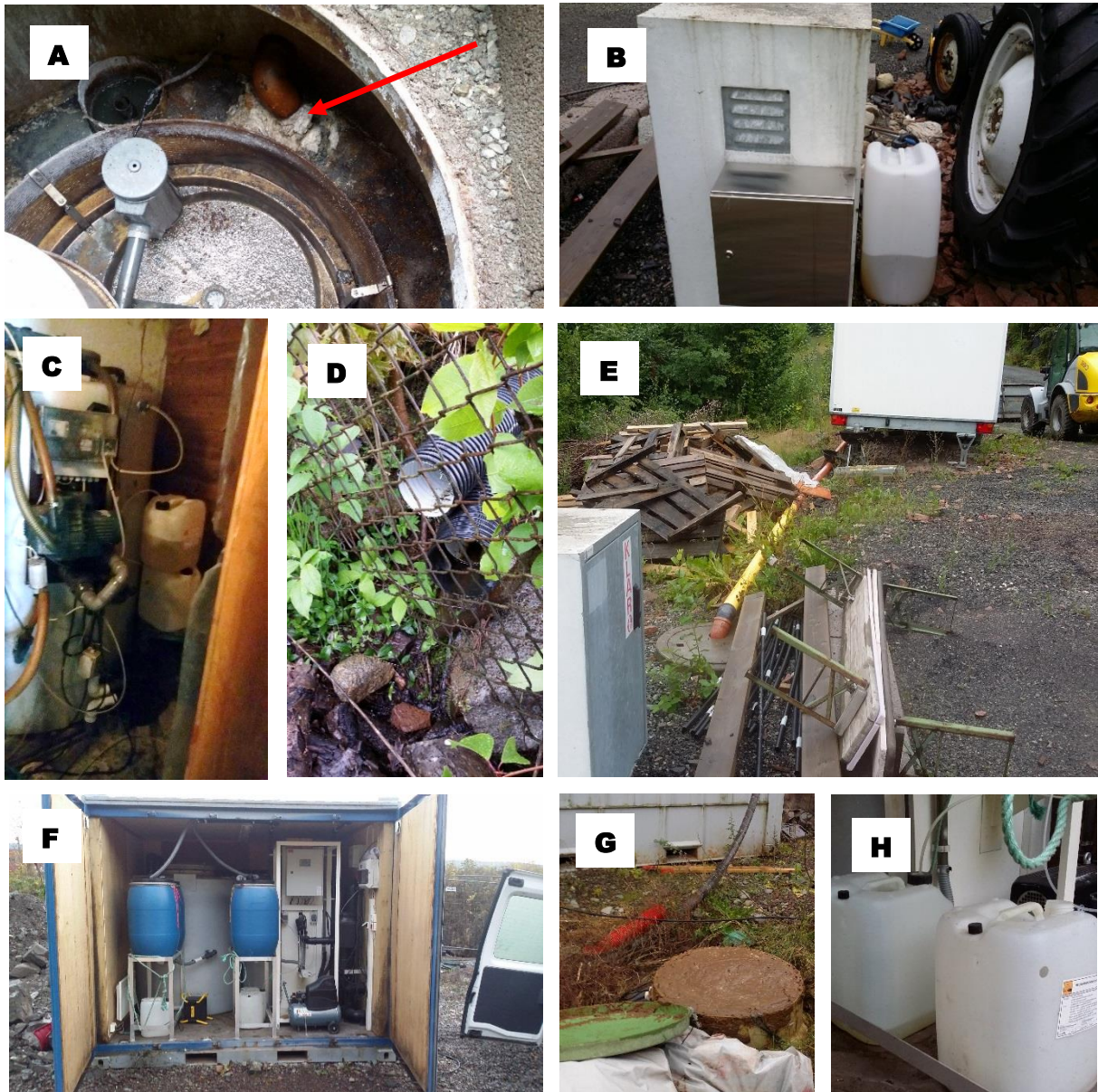
Figur 6: Eksempler på observasjoner av feil og mangler som bør være enkle å rette opp, fra prøvetaking av minirensanlegg. A) Eier har brukt resirkulert toalettpapir som ikke løser seg opp i rensanlegget. Proppen (markert med rød pil) er nå i fred med å tette hele anlegget. B) Kjemikalietanken står ikke frostfritt, noe som kan være problematisk om vinteren. Tanken skal heller ikke være tilgjengelig for barn eller andre uvedkommende. C) Her står tanken med renskemikalier for smittestoffer ustabil oppå tanken med renskemikalier for fosfor. Kjemikaliet som brukes er hydrogenperoksid, som er irriterende for hud og øyne. D) Renset avløpsvann skal ledes til grunnen eller til elv med årssikker vannføring. Her ledes restutslippet til naboens eiendom. E) Her er det koblet på avløpsvann fra campingvogn uten at rensanlegget er dimensjonert for dette. F) Rensanlegg i container brukt på byggeplass. Ansvarsforholdene mellom byggherre, entreprenør, underleverandør og servicefirma var uklare. Slamavskiller / pumpekum tilhørende anlegget var overfylt av slam og pompa ødelagt (G) og begge kjemikalietankene var tomme (H). Etter vårt besøk ble hele anlegget fjernet.
