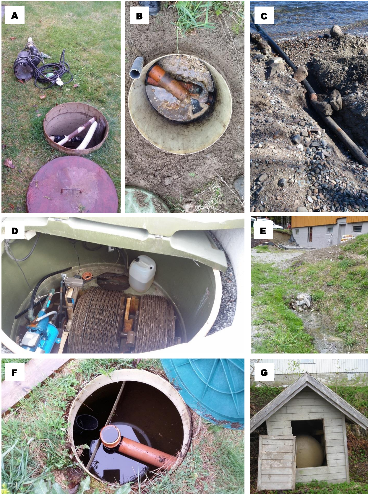
Figur 10: Vanlige feil og mangler. A) Sjøfører på tømmebil måtte ta opp lensepumpe fra tett tank. B) tett tank med montert utløp. C) Provisorisk retting av ledningsbrudd, ikke sikret mot frost og bølger. D) Montert vannpumpe i minirensanlegg. E) Utløp av urensert kloakk til terreng. F) Høy vannstand i gråvannsanlegg pga. tett utløp. G) Kloakktank ikke tilgjengelig for tømning, og heller ikke frostsikret. 12
